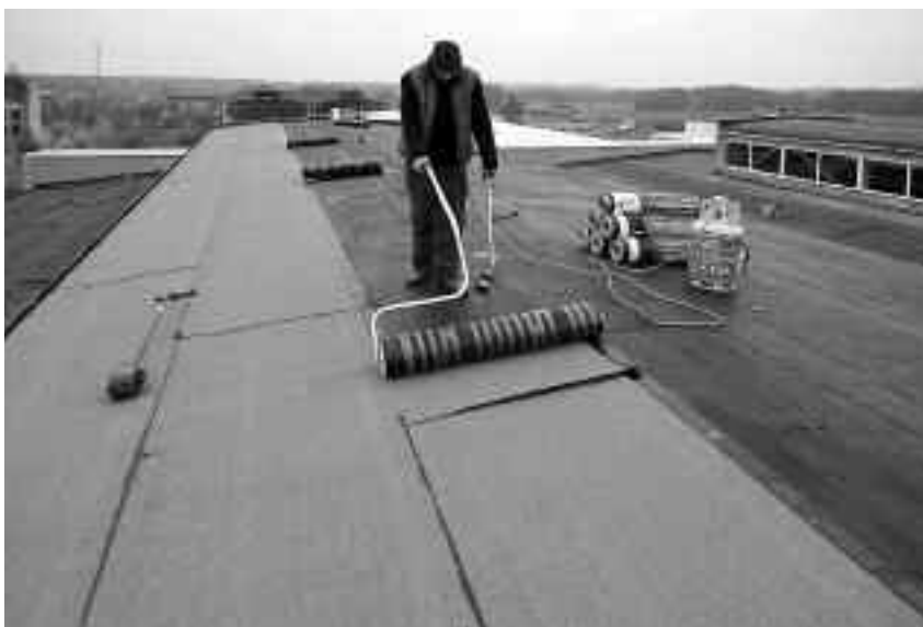
Układanie papy Szybki Syntan SBS, nowej generacji hydroizolacji dachów płaskich, na jednym z obiektów w Polsce
