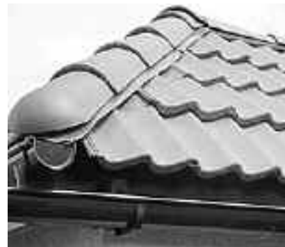
Fot. 3. Nieprawidłowy montaż gąsiorów
