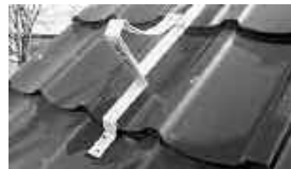
Fot. 11. Wspornik pod ławę kominiarską jako wspornik pod płotek na blachdachówce ja dachu. Najczęściej tego rodzaju błędny montaż można zaobserwować na pokryciach blachdachówką.
