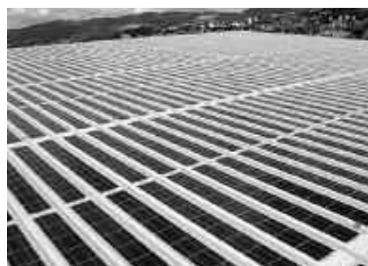
Pokrycie stadionu sportowego z zastosowaniem ARSOLAR-u o mocy 201 000 Wp – 3000 m 2
