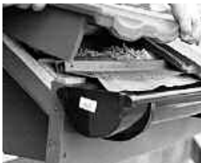
Fot. 1. Brak wentylacji połaci dachowej między dachówką a folią
