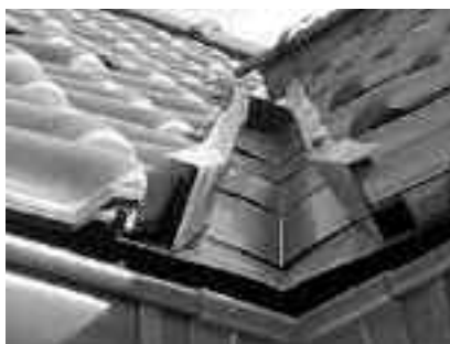
Fot. 4. Żle wykonany kosz
