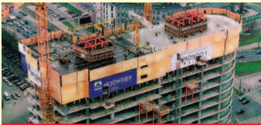
Fot. 2. Realizacja kompleksu biurowego Rondo 1 w Warszawie z zastosowaniem systemu ACS i osłon zabezpieczających CPP firmy PERI
