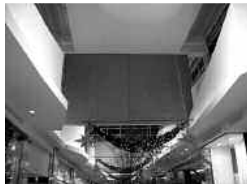
Fot. 3. Przykład kurtyny dymowej zamontowanej w centrum handlowym
