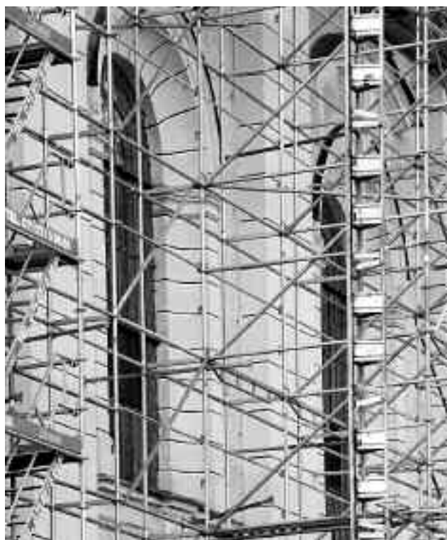
Fot. 1. Ramy STAR w połączeniu z rusztowaniem Allround przy kościele w Zwifalten
