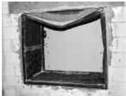
Fot. 1. Odkształcenia przewodu na skutek działania warunków pożarowych w miejscu przejścia przez ścianę w przypadku braku wzmocnień
