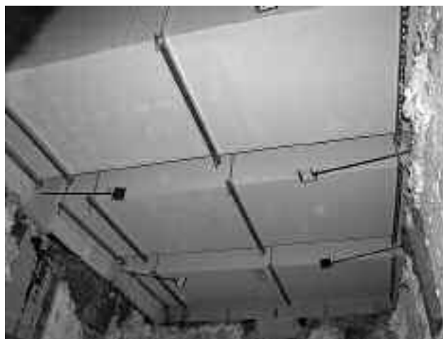
Fot. 3. Widok kanałów kablowych zainstalowanych na stanowisku badawczym Fot. arch. ITB
