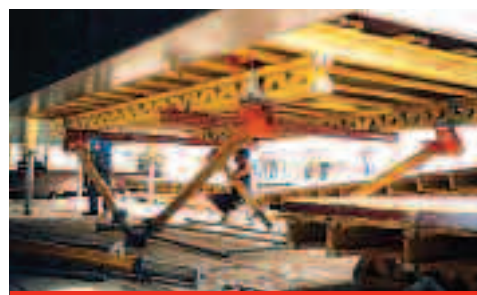
Fot. 4. Stoły stropowe PERI wykorzystane przy realizacji płyty pomostowej M1 mostu Świętokrzyskiego w Warszawie
