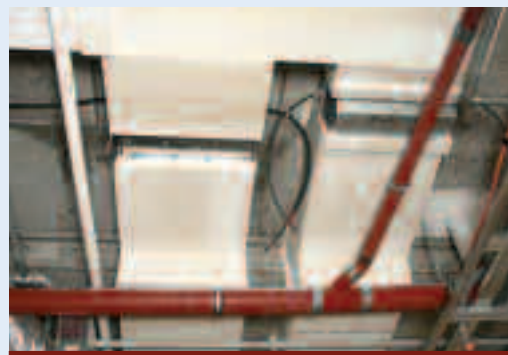
Fot. 2. Przewody wentylacji pożarowej wykonane z płyt RIDURIT
