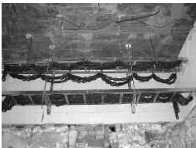
Fot. 2. Widok zespołów kablowych zainstalowanych na stanowisku badawczym Fot. arch. ITB
