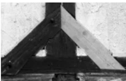
Fot. 3. Niewłaściwie wykonane połączenie starych i nowych elementów ściany
