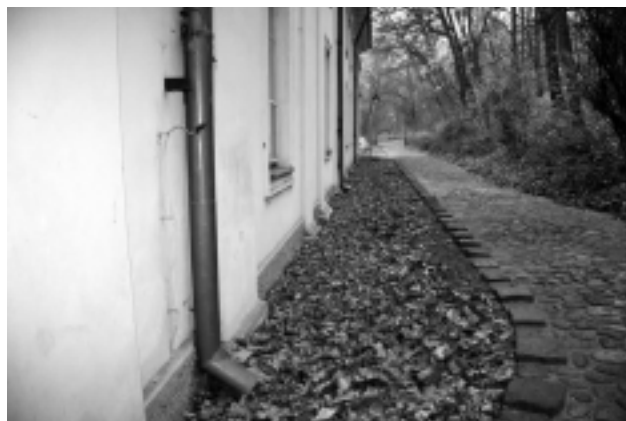
Fot. 2. Rów odwadniający od strony skarpy zasypyany opadłymi liśćmi
