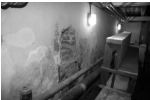
Fot. 1. Skutki destrukcyjnego działania wilgoci na mury piwniczne Starej Pomarańczarni
