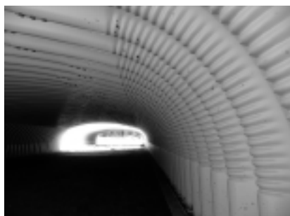
Fot. 9. Przejście dla zwierząt z blach falistych typu SuperCor z dodatkową powłoką polimerową Fot. A. Wysokowski
