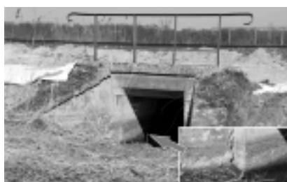
Fot. 2. Przepust kolejowy z betonu z początku XX w. Widoczna korozja betonu w wyniku wieloletniego oddziaływania cieku wodnego Fot. A. Wysokowski
