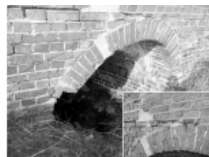
Fot. 1. Przykład przepustu z cegły z początku XX w. W sklepieniu przepustu widoczne ubytki Fot. A. Wysokowski
