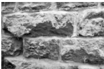
Fot. 1. Skutki destrukcyjnego działania wilgoci na murach piwnicznych kościoła Wszystkich Świętych w Warszawie – wysolenia na odsłoniętych murach
