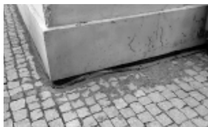
Fot. 2. Fragmenty niemocowanej i niezabezpieczonej izolacji pionowej
