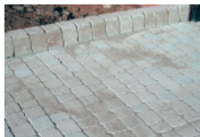
Fot. 7. Zapiaskowana nawierzchnia
