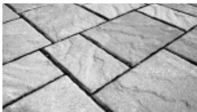
Fot. 1. Fragment nawierzchni z wibroprasowanej kostki brukowej z odciskiem powierzchni strukturalnej
