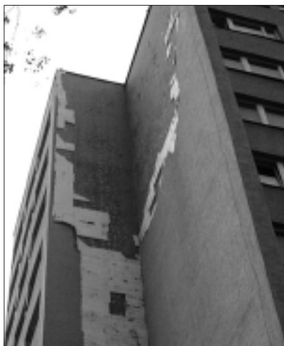
Fot. 1. Oderwany fragment elewacji ETICS (budynek mieszkalny)
