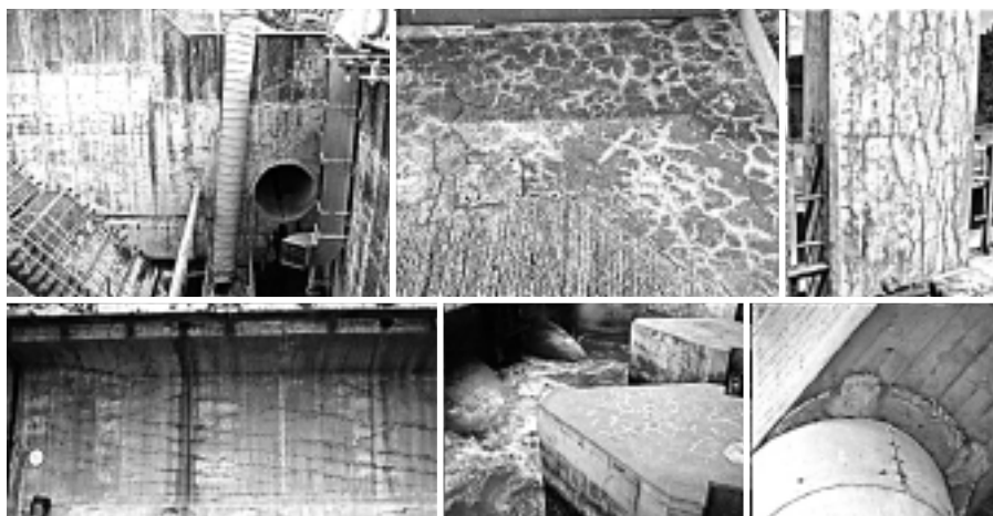
Fot. 1. Przykładowe spękania konstrukcji wywołane reakcją alkaliczną [8]
