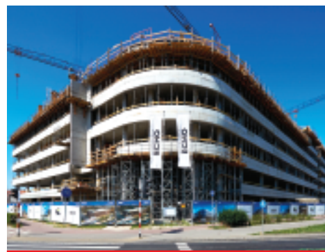
WEST GATE – biurowiec we Wrocławiu, na budowie którego wykorzystano deskowania firmy ULMA [Fot. archiwum ULMA]
