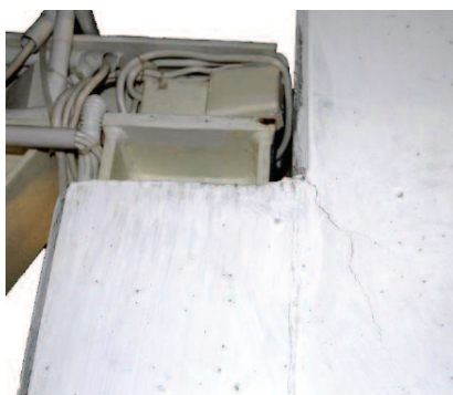
Zarysowanie lewej strony głowicy słupa The cracking on the left side of the column's head
