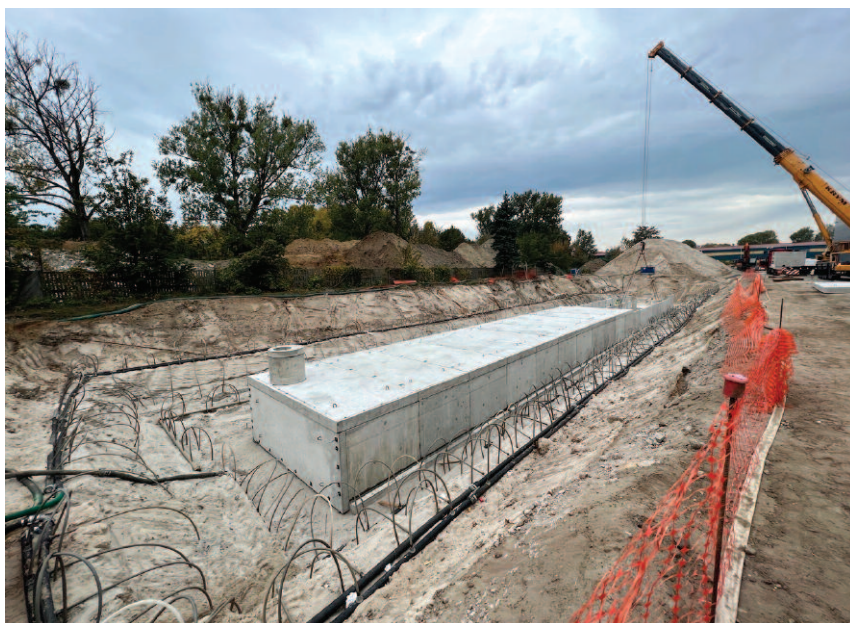
Fot. 2. Zbiornik retencyjny na wodę opadową
