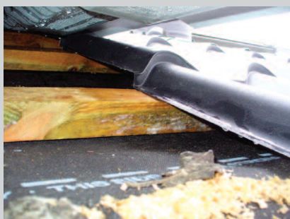
Fot. 4. Brak wentylacji spowodował po 1,5 roku powstanie pleśni na latach w całym dachu
