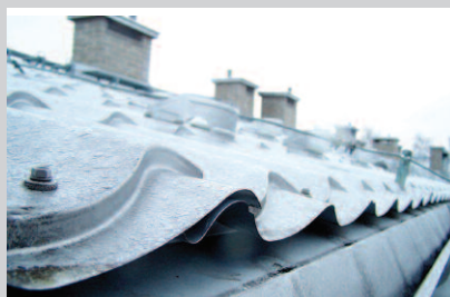
Fot. 1. Fałszywy profil nie ma odpowiedniego pola przekroju. Jest za mały, aby wentylować pokrycie (zasada wg rysunku 1)
