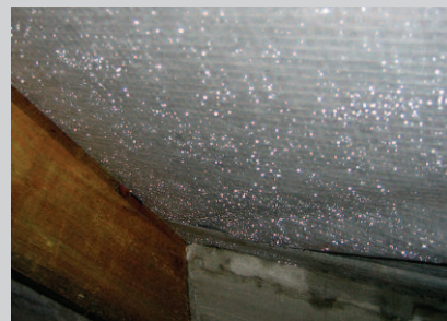
Fot. 3. Skroplina jest efektem intensywnych, mokrych prac wykończeniowych prowadzonych przy silnym mrozie na zewnątrz
