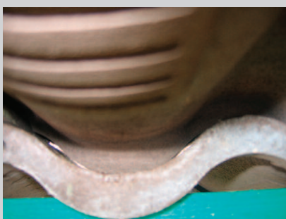
Fot. 6. Dachówka betonowa od spodu. Na zamku poziomym każdej dachówki jest dużo szczelin i dlatego podczas ulewnych deszczy oraz śnieżyc opady dostają się pod dachówki
