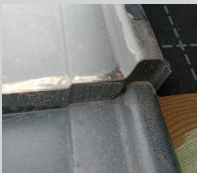
Fot. 5. Woda w zakładzie i osad na brzegu profilu płaskiej blachodachówki modułowej. To efekt antracytowego koloru i płaskości powierzchni
