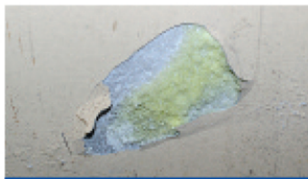
Fot. 2. Przykład destrukcji powłok malarskich oraz tynku renowacyjnego po upływie 2 lat od aplikacji. Żółtawe wykwity soli budowlanych są wynikiem osadzenia w mokrej ścianie puszek instalacji elektrycznej za pomocą zaprawy gipsowej
