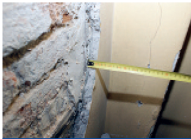
Fot. 1. Przykład wadliwej aplikacji tynku renowacyjnego na zawilgoczonej ścianie. Warstwa tynku uległa odparzeniu od podłoża w wyniku braku obrzutki, a w miejscu, gdzie wykonano nadbudowę narożnika ściany przy użyciu tynku renowacyjnego, wystąpiła pionowa rysa. Ponadto widoczne są wypełnienia ubytków (puszki instalacji elektrycznej) przy użyciu zaprawy gipsowej
