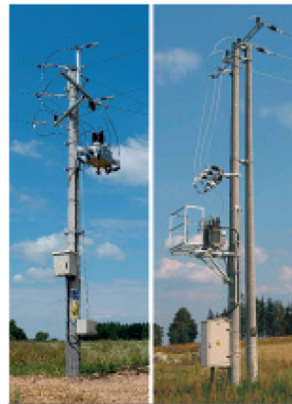
Fot. 6. Stacje transformatorowe na słupach typu E
