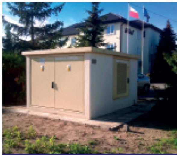
Fot. 5. Kontenerowa stacja K SZ 2900/2100
