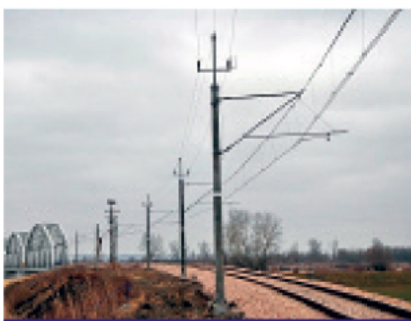
Fot. 8. Słupy ETG na łuku linii kolejowej
