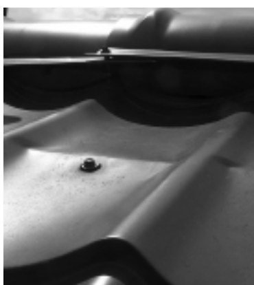
Fot. 2. Dach ma 4 lata. Brak wentylacji pokrycia spowodował przegnicie lat i poluzowanie wkrętów mocujących. Pod gąsiorem jest profilowana uszczelka z pianki PE, która uniemożliwia wentylację i jest przyczyną poluzowania wkrętów [Fot. K. Patoka]
