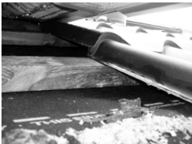
Fot. 1. Dach bez wentylacji pokrycia, bez wlotu w okapie i wylotu na kalenicę z MWK (jak na fotografii 2). Ilość skroplin jest ogromna, ponieważ niewentylowana przestrzeń pod blachą gromadzi wilgoć. Łaty są już spleśniałe, a dach ma 1,5 roku [Fot. Z. Buczek]
