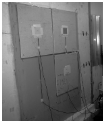
Fot. 1. Pierwsza dodatkowa warstwa (płyty gipsowo-kartonowe: górne z dodatkiem PCM, dolna referencyjna bez PCM) Photo. 1. The first additional layer (gypsum cardboard: the upper ones with the addition of PCM, the lower reference one without PCM)
