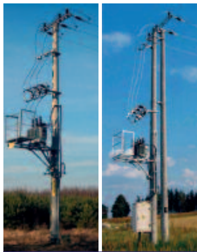
Fot. 4. Stacje transformatorowe na słupach typu E Photo 4. Transformer stations on poles type E
