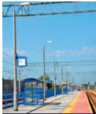
Fot. 5. Słupy oświetleniowe EOP Photo 5. Lighting columns EOP
