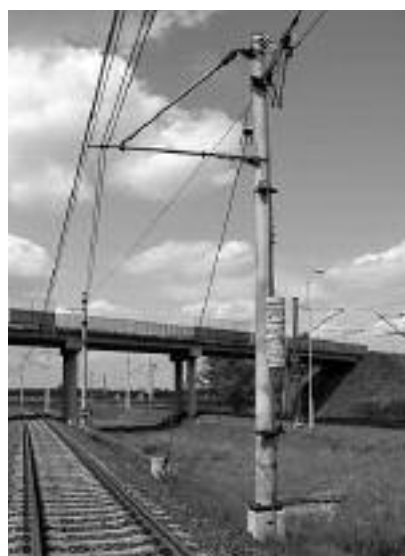
Fot. 2. Słupy trakcyjne typu ETG na torze doświadczalnym w Węglewie
