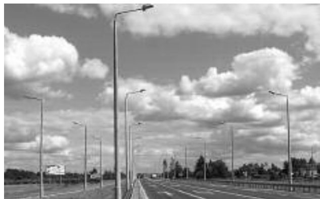
Fot. 1. Słupy oświetleniowe EOP przy drodze szybkiego ruchu Photo 1. EOP lighting poles by expressway
