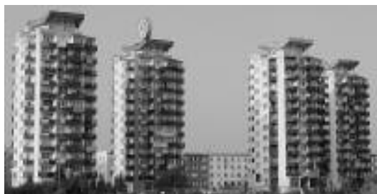
Fot. 1. Cztery wieżowce w Polkowicach uszkodzone w wyniku wstrząsu górniczego o dużej energii [Fot. Autor] Photo 1. Four tall building located in Polkowice damaged by high energy mining impact
