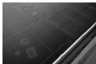
Fot. 4. Wcześniejsze naprawy membrany PVC uszkodzonej podczas usuwania śniegu z dachu Photo 4. Previous repairs of PVC membrane damaged during removing of snow from roof
