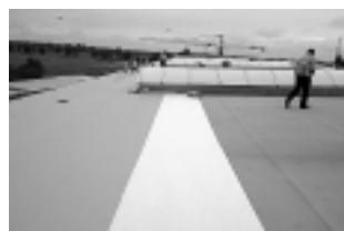
Fot. 3. Układanie nowej warstwy pokrycia dachu; w głębi świetliki nieszadzone podczas opadu gradu Photo 3. Assembling of new roof cover layers, in background: skylights undamaged by hail
