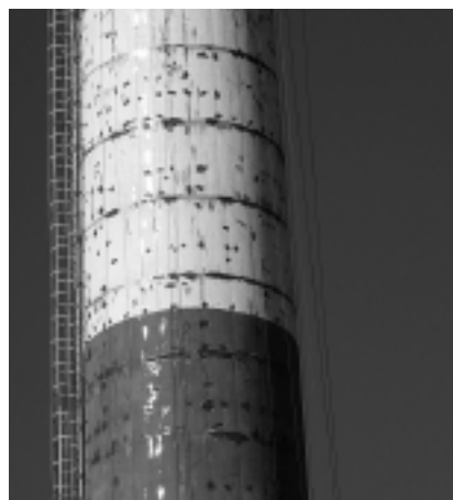
Fot. 1 Naprawiana powierzchnia kominu żelbetowego [2]
