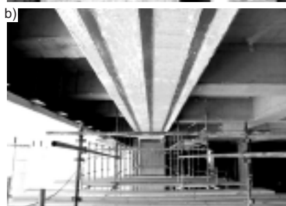
Fot. 1. Przykładowe wzmocnienia konstrukcji żelbetowych: a) – płyta oraz b) – belka, zbrojeniem doklejonym w postaci taśm z włókien węglowych
