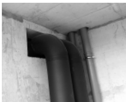
Rury stalowe izolowane w otulinie izolacyjnej oraz rynnny PVC
