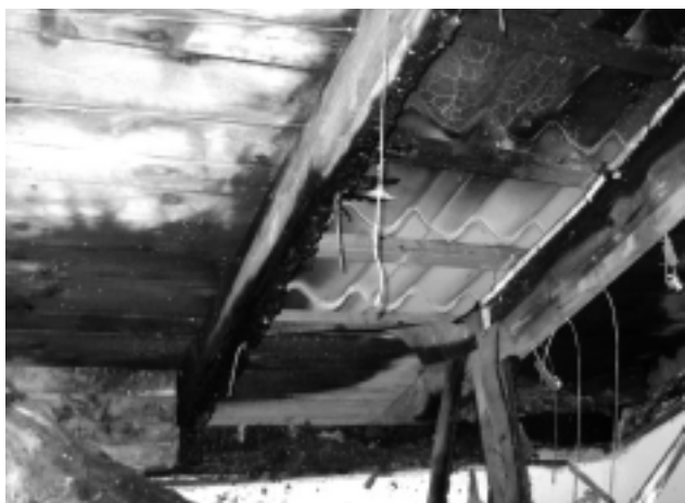
Fot. 2. Nadpalone elementy konstrukcji dachu [Fot. G. Kotulek]
