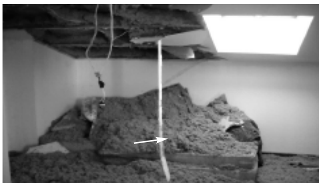
Fot. 1. Zniszczone płyty kartonowo-gipsowe wraz ze zmieloną celulozą [4]. Biała strzałka wskazuje rodzaj wykorzystywanego oświetlenia [Fot. G. Kotulek]
