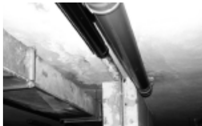
Fot. 3. Rynna zbierająca wodę przeciekającą przez nieszczelne dylatacje Photo. 3. "Gutter" collecting leaking water through the expansion joints
