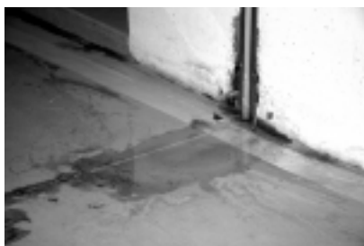
Fot. 1. Zastoiska wody tworzące się w wyniku wycieku wody przez dylatację Photo. 1. Stagnant water formed as a result of water leakage through the expansion joint
