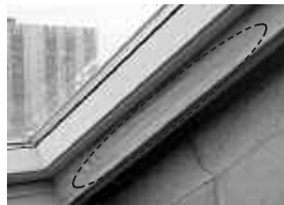
Fot. 4. Na ościeżnicy (element dolny) słój leżący (w elipsie), na skrzydle (element górny) prawie słoików nie widać
