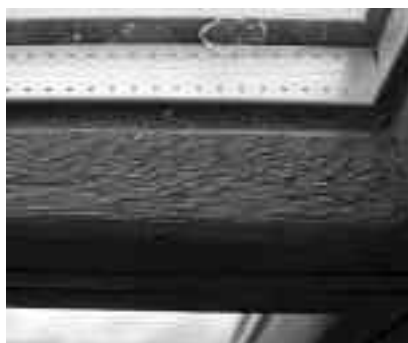
Fot. 13. Szorstka listwa przyszybowa. Skroplona woda spłynęła po szybie i zamoczyła listwy – efekt to puchnące listwy i ramy, odparzony lakier, kleszczenie okien, korozja okuć
