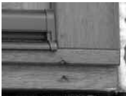
Fot. 11. Otwory owadzie na progu okna – praktycznie bez znaczenia (otwory po owadach występują rzadko i są na ogół słabo widoczne)
