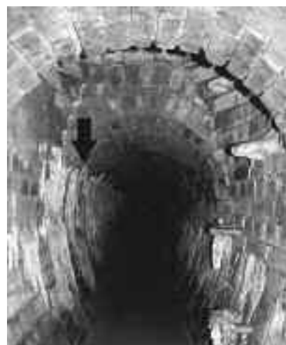
Fot. 3. Przecieki wody do wnętrza powodujące nacieki solne
