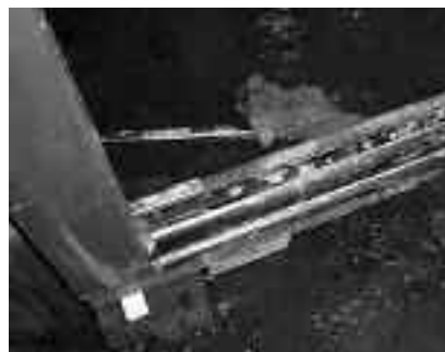
Fot. 14. Zniszczony zaprawą wapienną okapnik – drewna z wapna nie da się oczyścić
