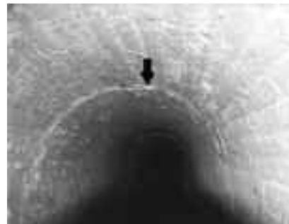
Fot. 2. Poprzeczne pęknięcie konstrukcji kanału
