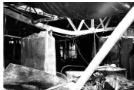
Odkształcenie konstrukcji stalowej po pożarze
