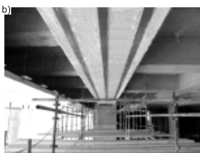
Fot. 1. Przykładowe wzmocnienia konstrukcji żelbetowej: płyty (a) i belek (b) zbrojeniem doklejanym w postaci taśm z włókien węglowych
