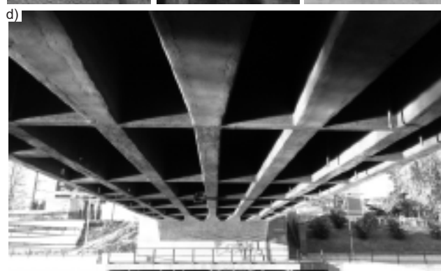
Fot. 5. Detale mostu Królowej Jadwigi ilustrujące stan aktualny (kwiecień 2014): a) uszkodzenie detalu architektonicznego; b) wykwyty soli na konstrukcji wsporczej lampy; c) uszkodzenia powierzchniowe schodów betonowych; d) widok z dołu konstrukcji nośnej pomostu
