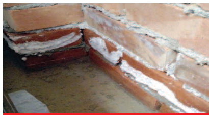
Fot. 3. Ściana testowa – brak izolacji poziomej, widoczne wysolenia
