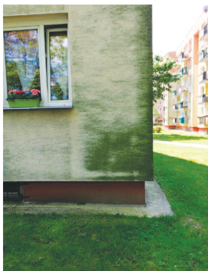
Fot. 1. Korozja biologiczna zaburza estetykę elewacji
