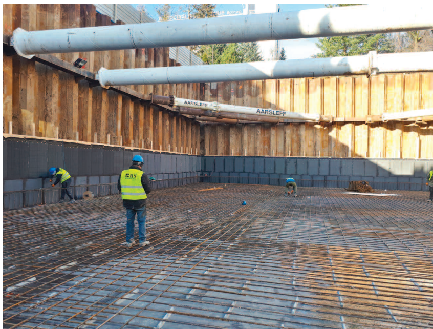
„Apartamenty Butikowe” w Białymstoku, system izolacji przeciwwodnej COLPHENE BSW – montaż zbrojenia płyty fundamentowej na membranach COLPHENE BSW H i COLPHENE BSW PROTECT`R
