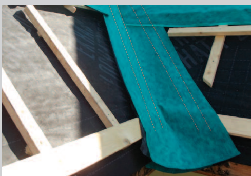
Fot. 2. Kosz w opisywanym dachu ma dwie kontrłaty koszowe, a kontrłaty połaciowe nie stykają się z nimi
