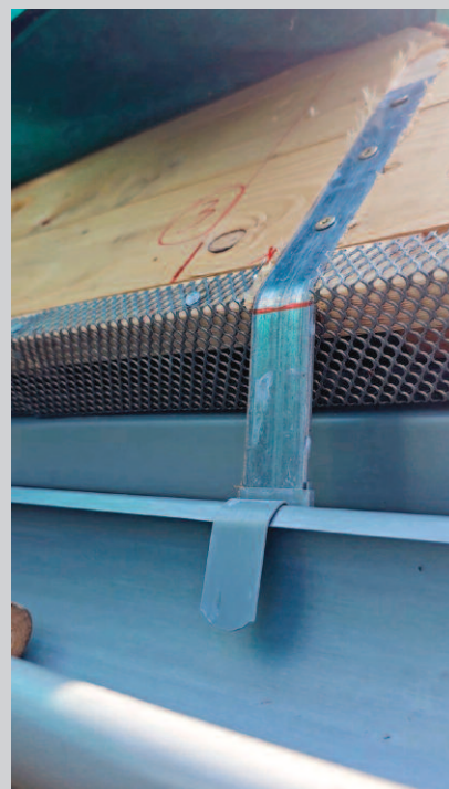
Fot. 3. Okap z rynną niską, czyli mocowaną pod wlotem powietrza. Wlot osłonięty taśmą perforowaną znajduje się na końcu kontrłat
