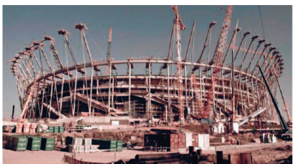
Fot. 25. Obiekt sportowy. Konstrukcja żelbetowa wypełniona m.in. elementami murowymi z ABK. Stadion Narodowy w Warszawie (2010 r.) Fot. H+H [12]
