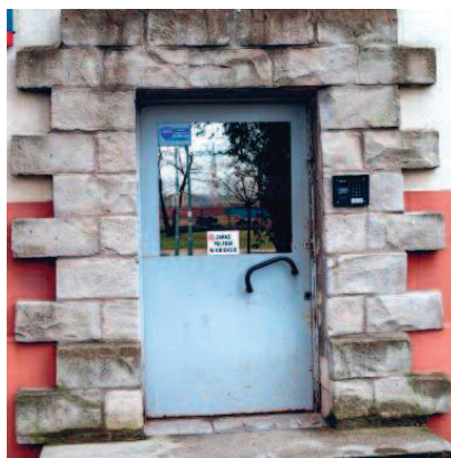
Fot. 2. Widok wejścia do COBR PB CEBET, wykończonego bloczkami z ABK, po 62 latach od momentu wybudowania
