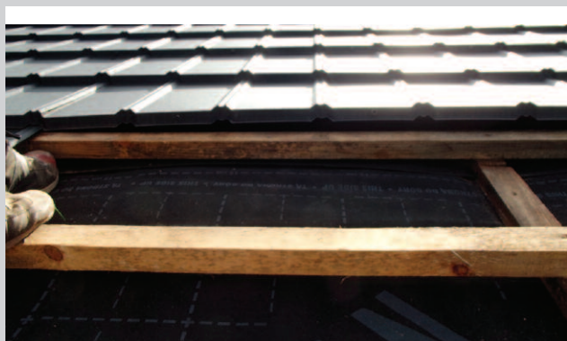
Fot. 1. W tym dachu pianki OKPUR wypchnęły MWK w stronę pokrycia, co spowodowało zablokowanie wentylacji i powstanie zawilgocenia kontrłat w okolicach okapu
