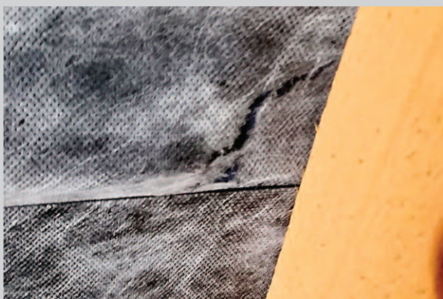
Fot. 2. Typowe uszkodzenie w wyniku działania UV (podobnie jak na fotografii 1), ale oglądane od wewnątrz. Skoro możemy obejrzeć takie pęknięcie w świetle słonecznym, to wniosek jest oczywisty: poddasze jest obficie doświetlone przez okna dachowe, lukarny i wylaz. Poddasze zostało zaprojektowane jako mieszkalne, ale nie było wykończone
