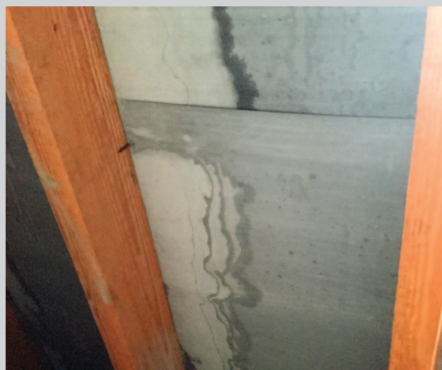
Fot. 3. Bardzo często na membranach występują zacieki powstałe z soli wypłukanej z lat i kontrłat, która pochodzi z impregnatów wadliwie przygotowanych z koncentratów. To jest również pośredni dowód na brak wlotu i wylotu ze szczeliny utworzonej przez kontrłaty. W takim dachu jest bardzo dużo skroplin osadzających się na listwach
