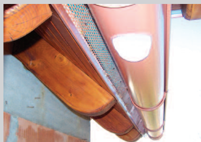
Fot. 3. Dach w trakcie prac dekarских. Rynna wysoka zamocowana została do dwóch łat okapowych za pomocą rynaż (haków wykonanych z płaskownika). Wlot osłonięty kratką z PCW, leżącą na kapinosie, jest pod rynną
