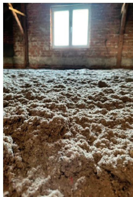
Fot. 1. Przykład zastosowania izolacji celulozowej na poddaszu nieużytkowym Photo 1. Example of using cellulose insulation in an unused attic
