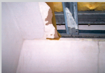
Fot. 1. Zima 2010 r. Niewłaściwie ułożona paroizolacja umożliwiła powstanie przewiewów przez przegrodę. W efekcie powstały zacieki ze skroplonej pary wodnej zawartej w powietrzu wypływającym z wnętrza
