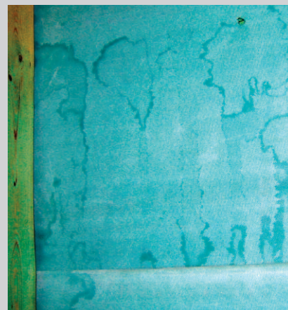
Fot. 3. Właściciel zauważył zacieki, ale zignorował dziury wykonawcze, które powinny zostać naprawione w trakcie układania pokrycia. Interpretacja tych mało szkodliwych zacieków była wyłącznie emocjonalna
