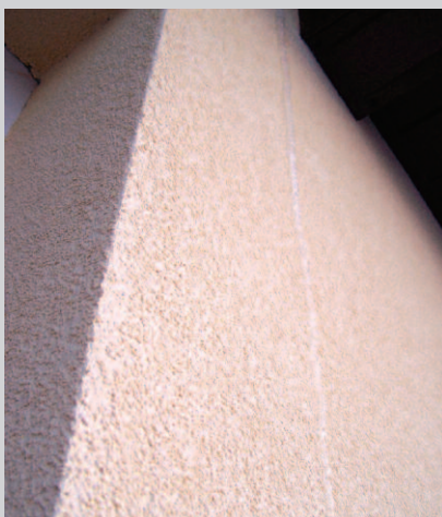
Fot. 2. Budynek z fotografii 1. Po stronie zewnętrznej długo panowała wysoka ujemna temperatura. Para wodna zawarta w przepływającym powietrzu po skropleniu tworzy długie sople na tynku
