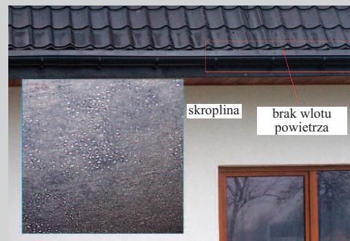
Fot. 4. Brak wlotu powietrza atmosferycznego w okapie oznacza brak wentylacji pokrycia i wzrost ciśnienia pary pod pokryciem. W takich warunkach powstają skropliny pod MWK
