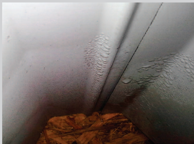
Fot. 1. Wnętrze dachu basenu. Połączenie blachy trapezowej ze ścianą budynku wykonaną z płyt OSB jest pełne szczelin. Zawilgocena wełna nad blachą konstrukcyjną stanowi słabą izolację i w efekcie blacha jest zimna przez większość dnia nawet latem. Skropliny tworzą często zacieki
