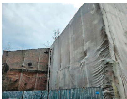
Photo 2. Rear elevation of the building with overgrown vegetation. March 2024 condition Fot. 2. Elewacja tylna budynku z porastającą roślinnością. Stan z marca 2024 r.
