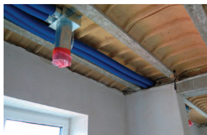
Instalacje umieszczone w stropie RECTOLIGHT
