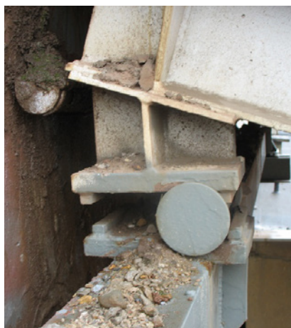
Photo 6. Blocked hinged movable support of the gallery Fot. 6. Zablokowana podpora przegubowo-przesuwna galerii
