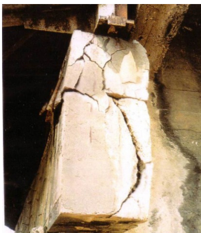
Photo 7. Damaged cantilever as a result of blocking the gallery’s ability to move Fot. 7. Wspornik uszkodzony w wyniku zablokowania możliwości przesuwu galerii
