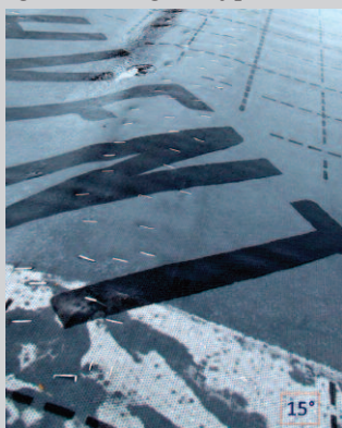
Fot. 1. MWK użyta jako pokrycie tymczasowe. Przy takim kącie nachylenia membranę należy mocować wg zasady z rysunku 3
