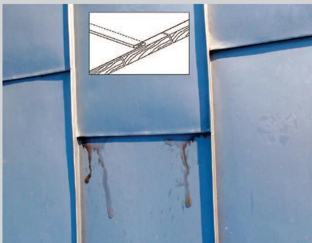
Fot. 2. Dach pokryty arkuszami blachy łączonymi na rąbki stojące z nieprawidłowo wykonanymi połączeniami poprzecznymi. Nachylenie połaci w tym miejscu jest mniejsze niż 5°, a takie połączenie można stosować przy kątach co najmniej 25° (rysunek 2)
